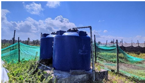
Bak Penampungan Air
